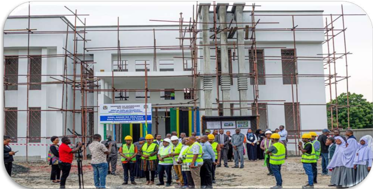
Wajumbe wa Kamati ya Kudumu ya Bunge ya Utawala, Katiba na Sheria wakikagua maendeleo ya Ujenzi wa Jengo la Mkoa wa Kimashtaka Temeke
